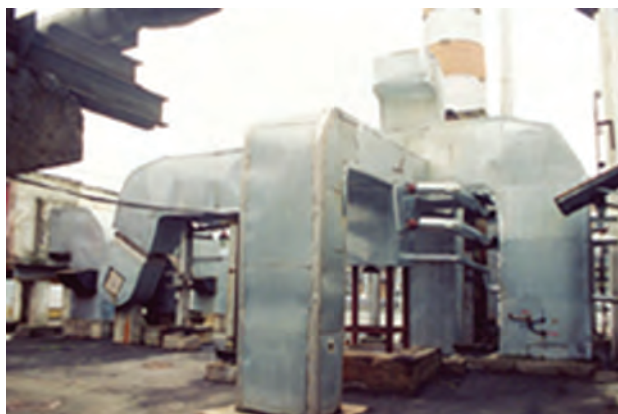
Теплоутилізаційна установка з теплоутилізатором ТПК-1,1-230 за котлом ДЕ-16-14ГМ у котельні ВАТ «Фармак» (м. Київ)
