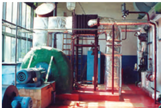
Теплоутилізаційна установка з конвективним пакетом ПК-1-102ш за котлом ТВГ-4р у котельні за адресою вул. Осиповського, 2А (м. Київ)
