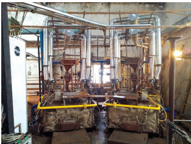
Загальний вигляд установки
