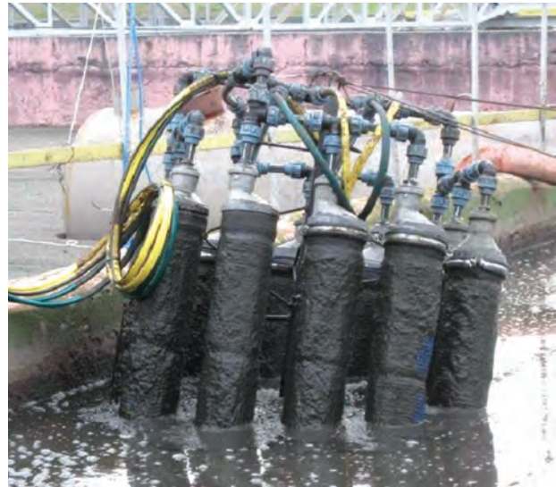
Фільтрувальний модуль в аеробному стабілізаторі БСА
