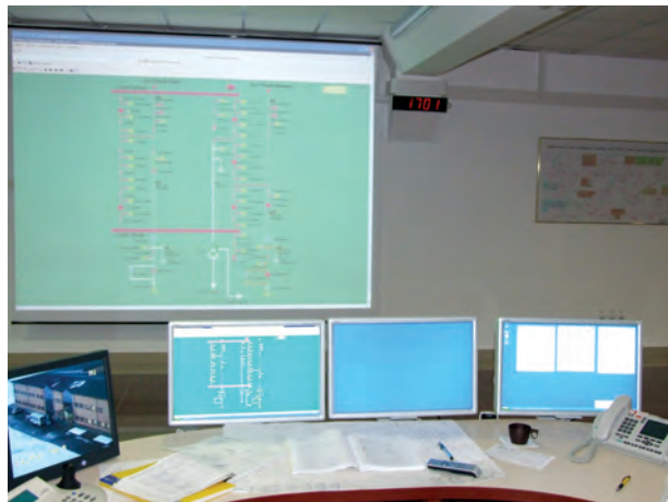
Зал керування підстанції 750 кВ «Київська»
