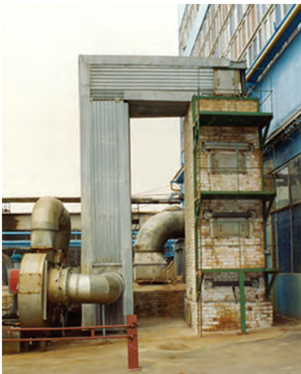
Теплоутилізаційна установка з теплоутилізатором ТВМ-20 за піччю № 3 Гостомельського скляозаводу (Київська обл.)
