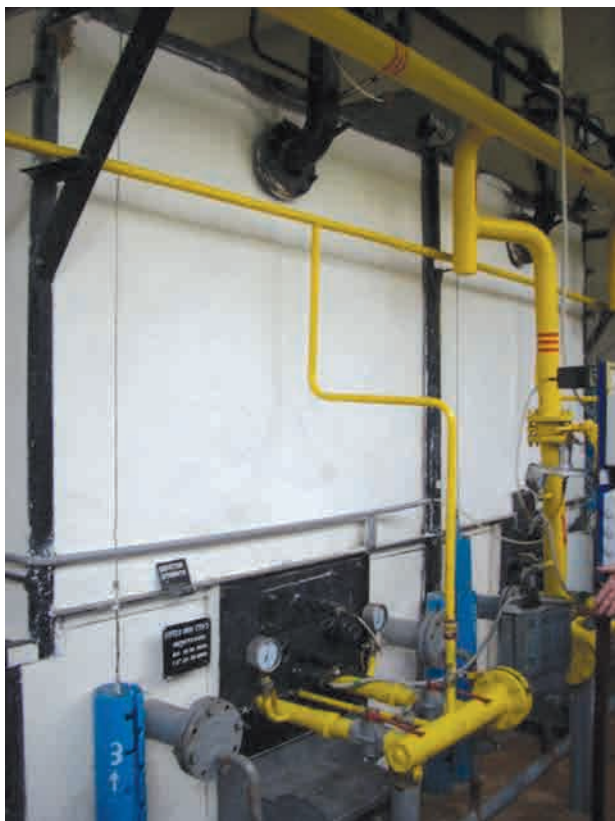
Змонтовані подові пальники у котлі НДІСТУ-5
