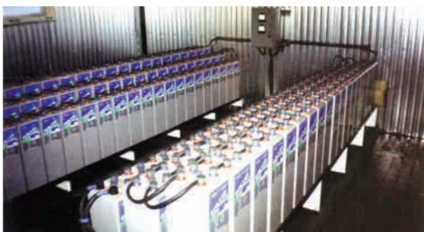
Система електронакопичення станції
