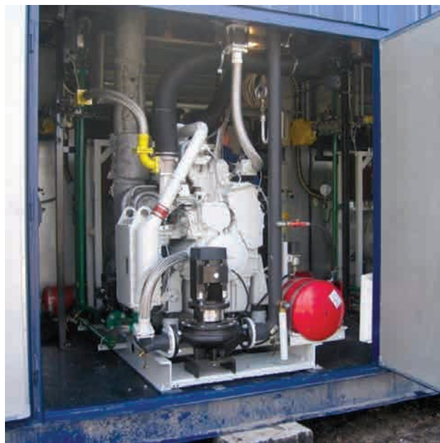
Газова електростанція на базі ДВС потужністю 185 кВт
