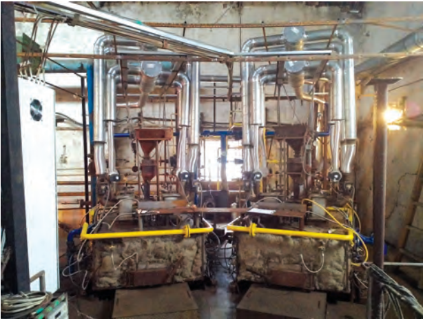
Загальний вигляд установки
