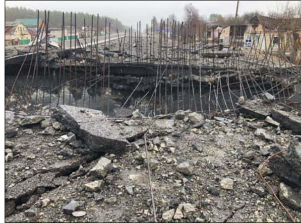
Руйнація траси Київ–Чернігів та пошкодження прилеглих територій
